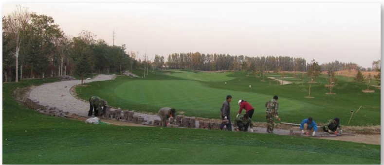
Ảnh trên: Thi công lining các bunker tại Tianjin Pearl Beach International Country Club Ảnh dưới: Sau khi hoàn tất việc trồng cỏ trên sân, đội xây dựng đang thi công đường cart
